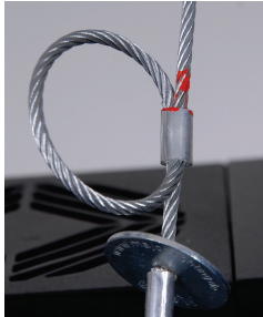
Farbmarkierung fehlerhaft d.h. Austauschen
